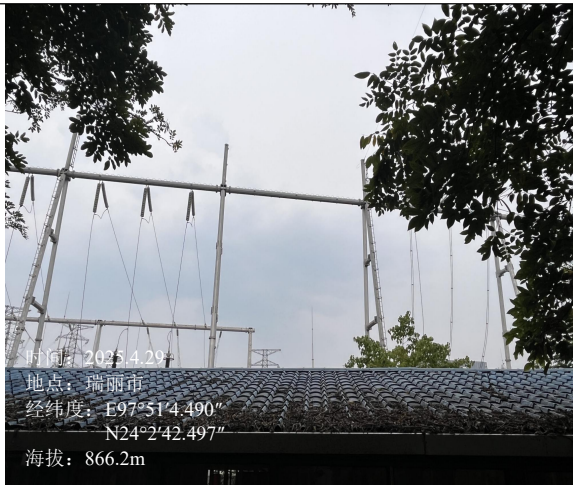
瑞丽变电站进线间隔
