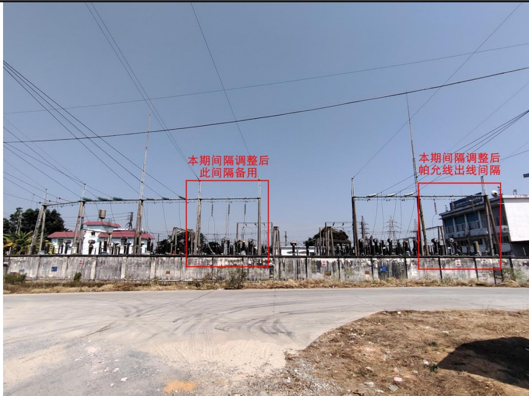
110kV 帕底变间隔调整侧实拍图
