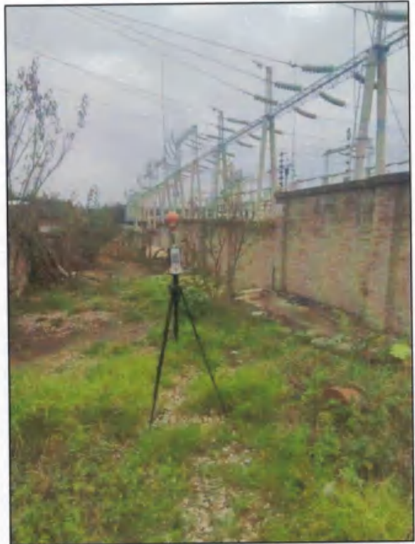
220kV权甫变至柳树变110kV出线间隔
