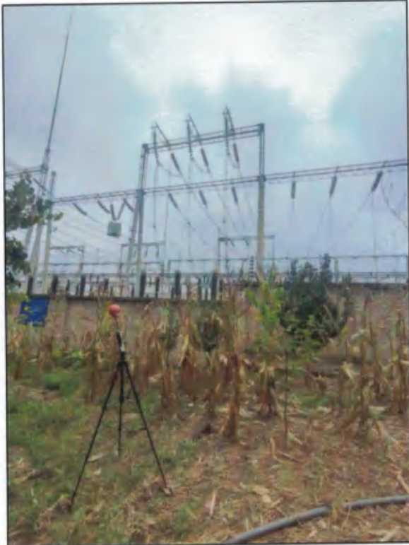
220kV权甫变至110kV双楣改接线出线间隔
