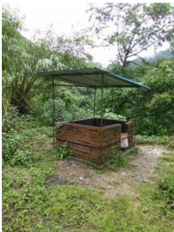
厂房区生活垃圾收集池
