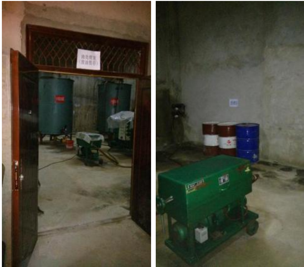
油处理及废油暂存间
