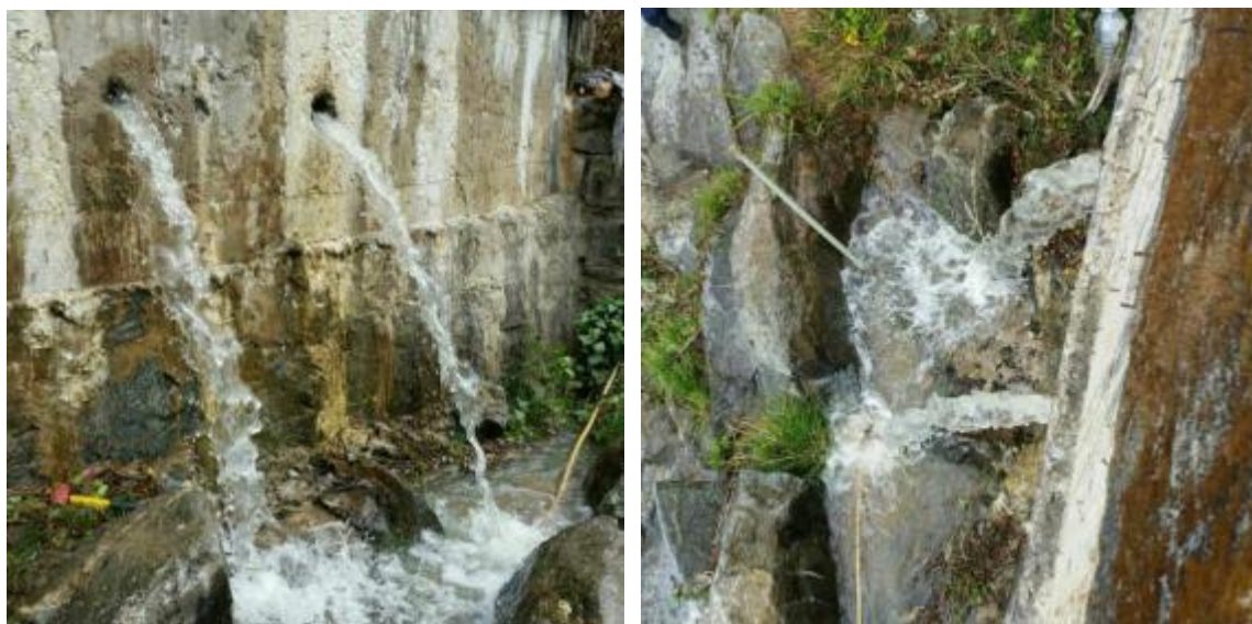
滚朋羊卡河取水坝生态用水下方措施
