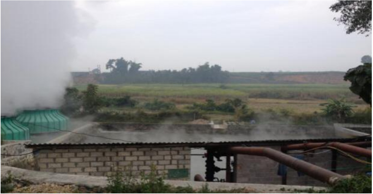
冷却水循环回水池
