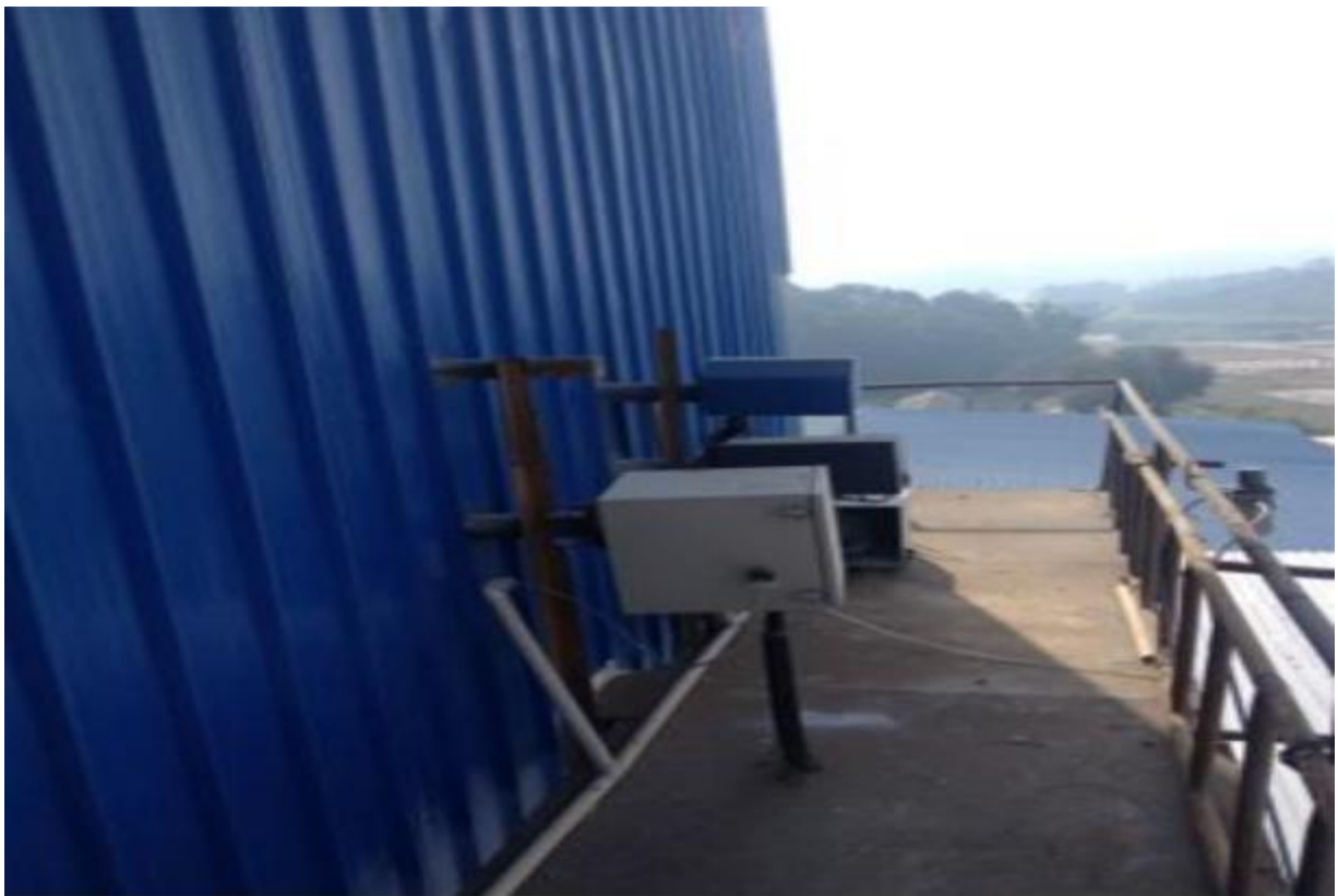
烟气在线监控仪及排气筒
