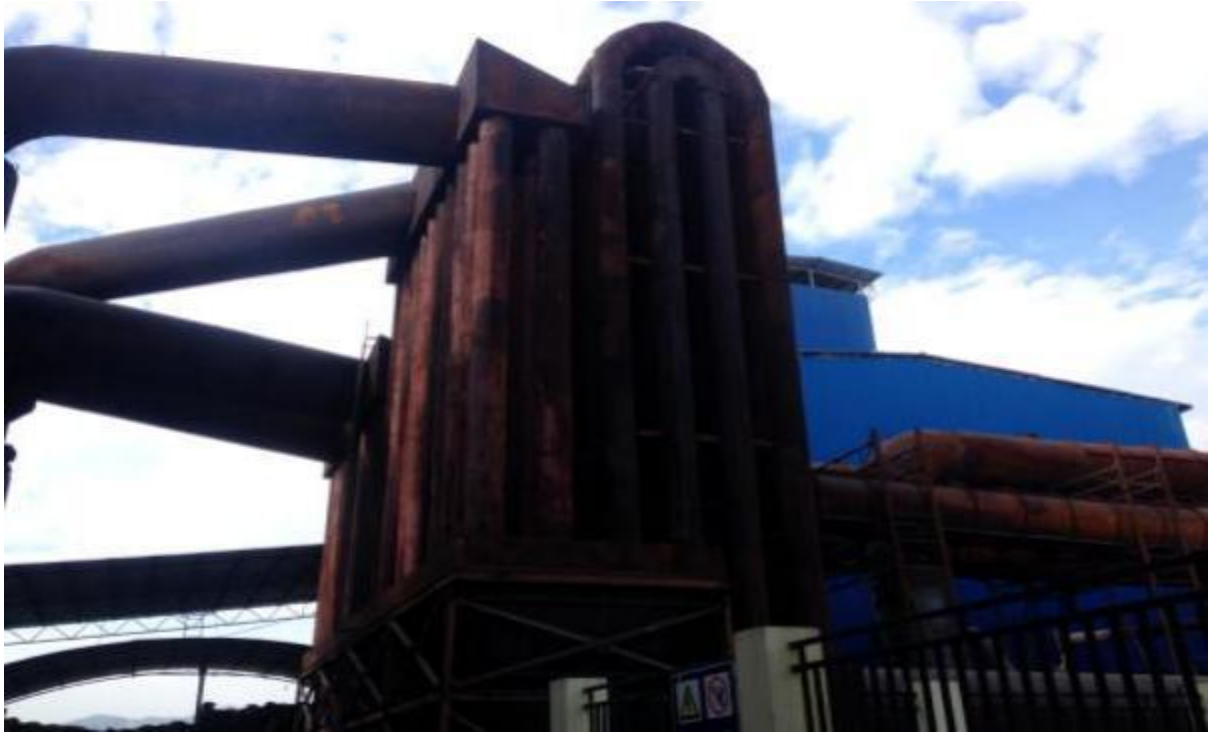
烟气除尘设施
