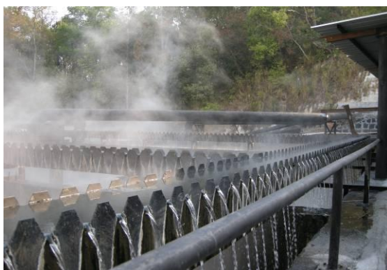
3200m 3 冷却循环回用水池
