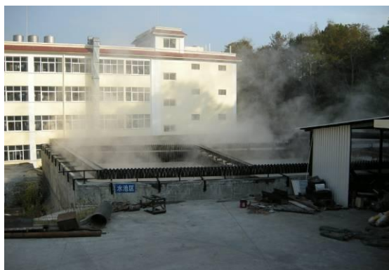
3200m 3 冷却循环回用水池
