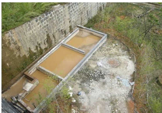
洗硅石水三级沉淀回用水池 (60m 3 )
