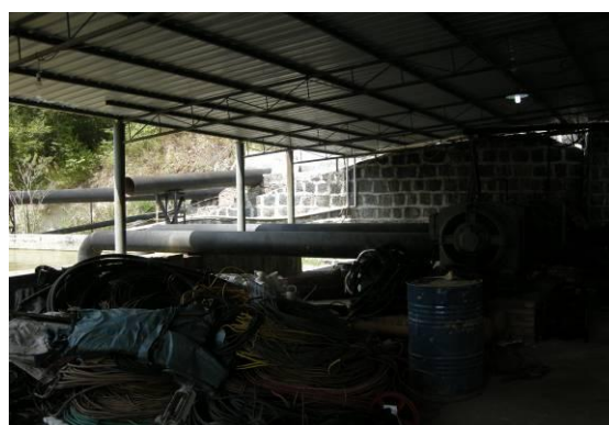
冷却循环回用水泵房
