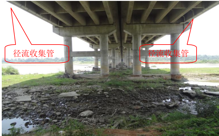
桥面下的径流收集管 I
