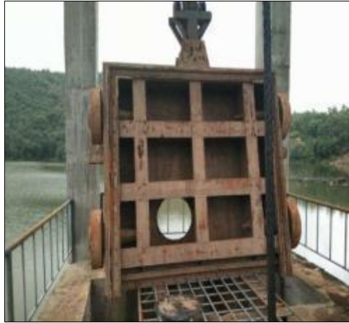
冲沙闸检修闸处生态泄流孔
