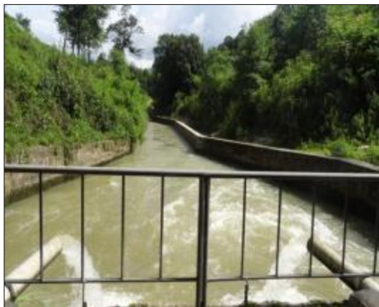
尾水渠挡水设施
