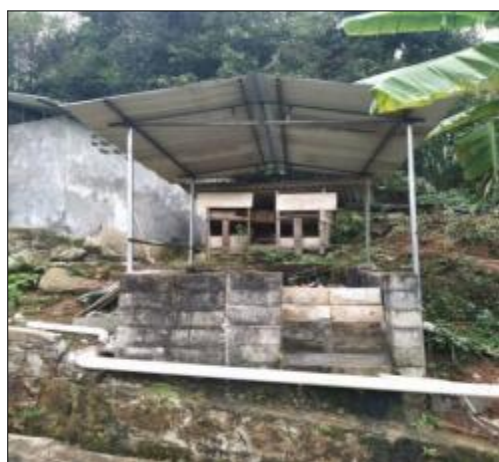
生活垃圾收集池
