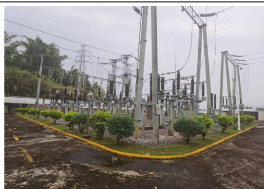
110kV 配电装置区
