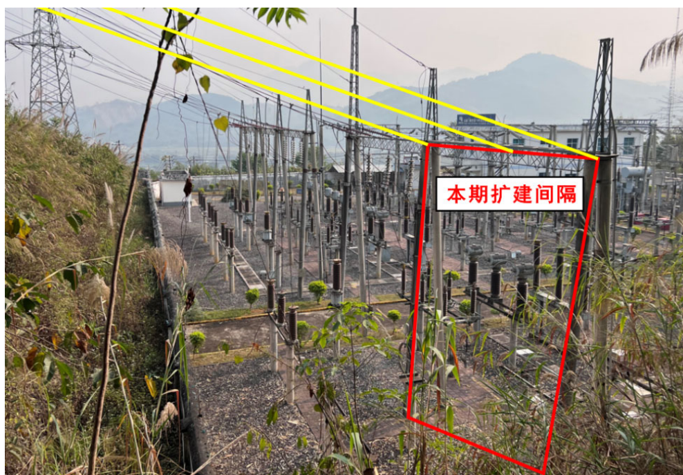
图2-5 110kV 芒弄变电站出线间隔侧
