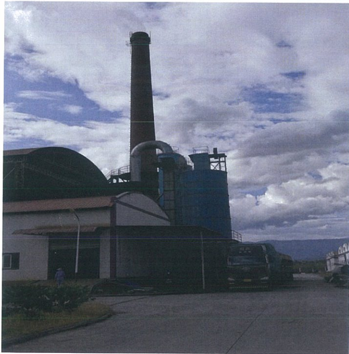
脱硫除尘设施
