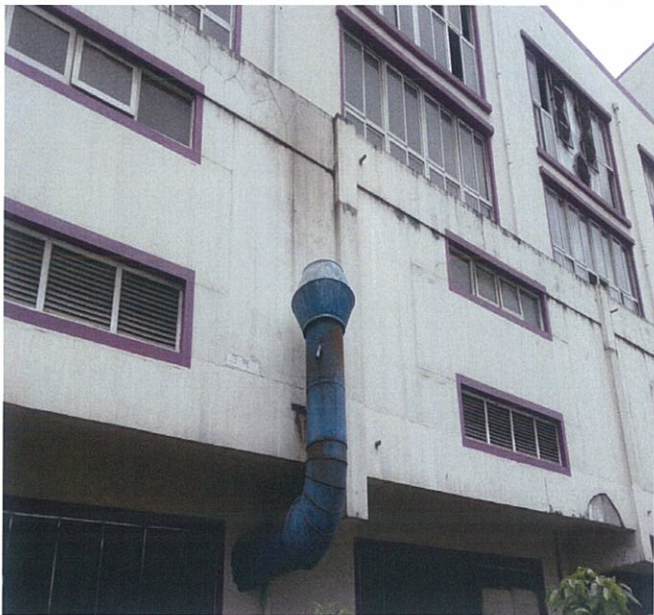
粉碎机排气筒
