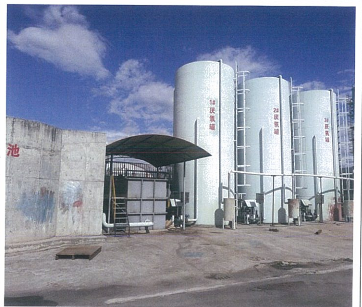
污水处理设施
