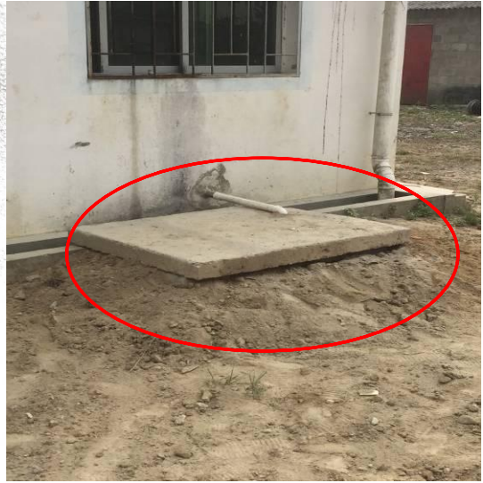
生活区隔油池
