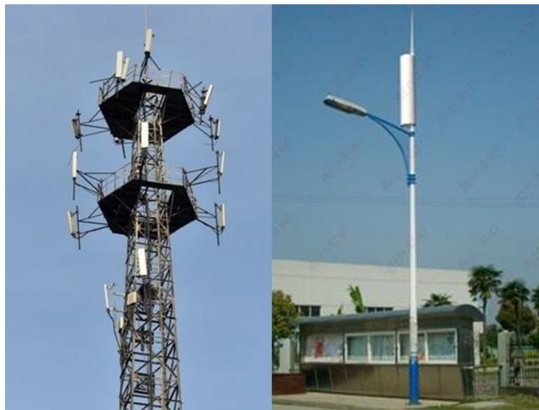
图 3 落地塔架设方式的基站
