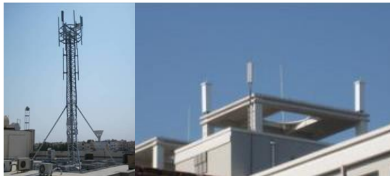
图 1 屋顶塔（四角塔与楼顶美化天线）架设方式的基站
