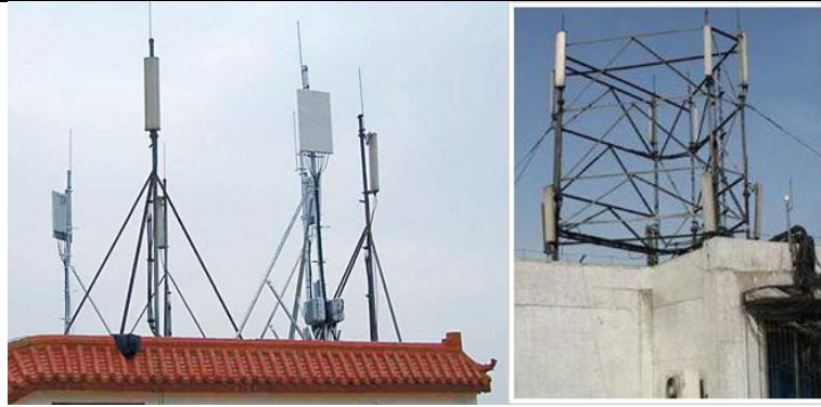
图 2 屋顶塔（抱杆与增高架抱杆）架设方式的基站
