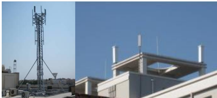
图 1 屋顶塔架设方式的基站
