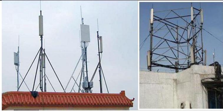
图 2 屋顶抱杆架设方式的基站
