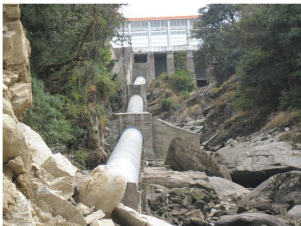
图 5-1 二期压力管道正面
