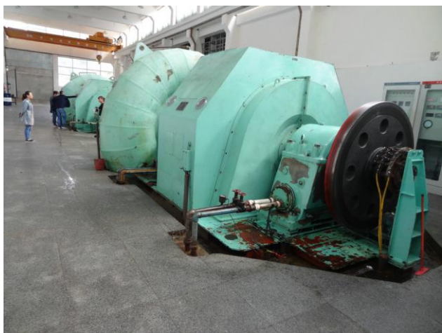
图 6-11 一期厂房新机组（卧式）
