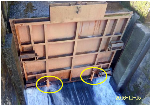
老一级站尾水闸设下垫面进行放流
