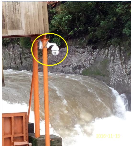
老一级站尾水渠生态放流监控
