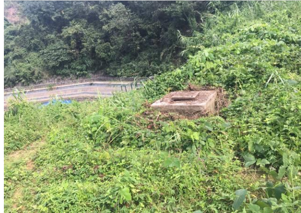
图片 14 调节池旁地下水监测井
