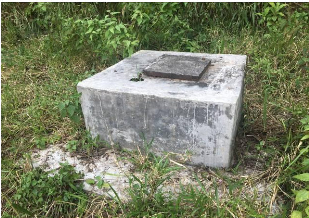
图片 13 填埋场区地下水监测井
