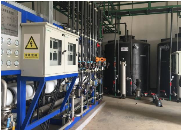
图片 19 渗滤液处理站 3
