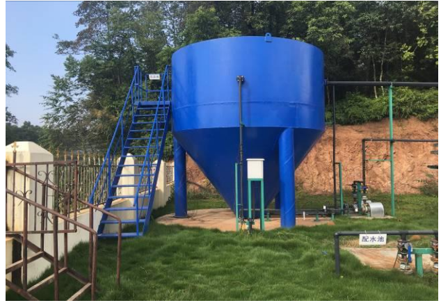
图片 18 渗滤液处理站 2
