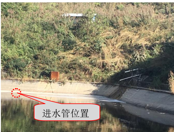
图 53 渗滤液调节池进水管
