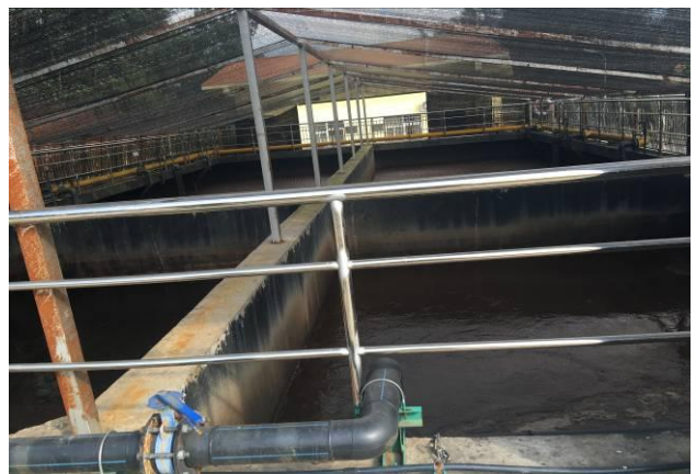
图片 20 渗滤液处理站 4
