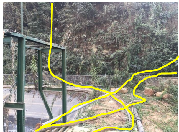
图 54 渗滤液调节池出水管
