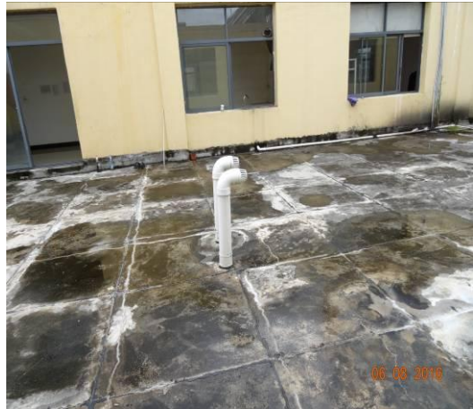
楼顶废气排放口
