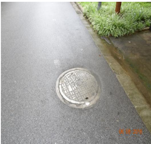
小区雨水管网
