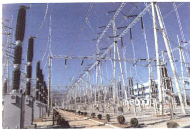
和省网相连的220千伏变电站
